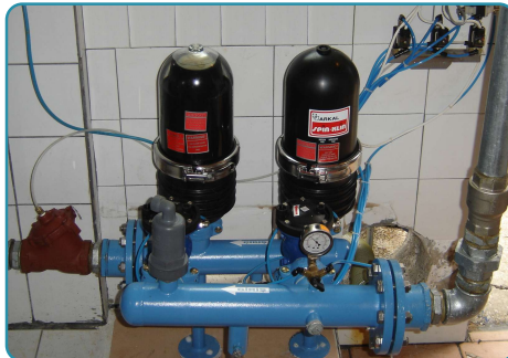
Kuyu Suyu Filtrasyonu 30 m 3 /h - Bursa
