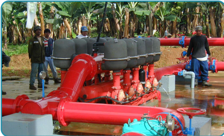
Damla Sulama Suyu Filtrasyonu 750 m 3 /h
