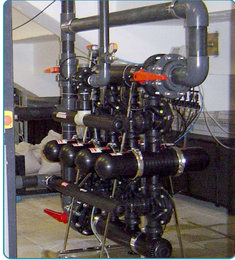
Deniz Suyu Filtrasyonu 60 m 3 /h - Bodrum
