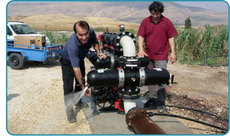
Damla Sulama Suyu Filtrasyonu 160 m 3 /h
