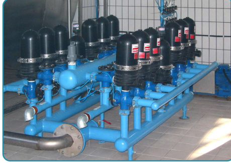
Soğutma Suyu Filtrasyonu 80 m 3 /h - Konya
