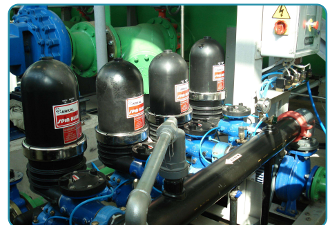
Soğutma Suyu Filtrasyonu 60 m 3 /h - Bursa
