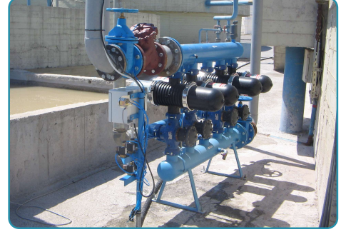
Atık Geri Kazanım Suyu Filtrasyonu 75 m 3 /h - İzmir
