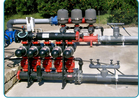
Damla Sulama Suyu Filtrasyonu 200 m 3 /h
