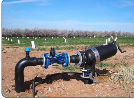
Damla Sulama Suyu Filtrasyonu 40 m 3 /h
