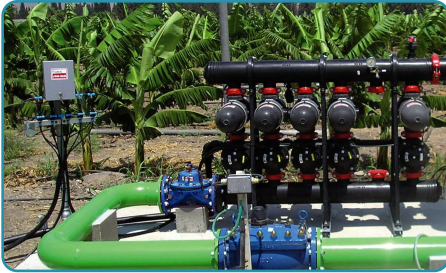
Damla Sulama Suyu Filtrasyonu 150 m 3 /h
