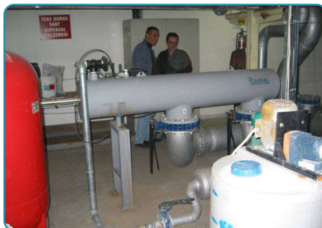
Elek Filtre ile Soğutma Suyu Filtrasyonu 160 m 3 /h - İzmir
