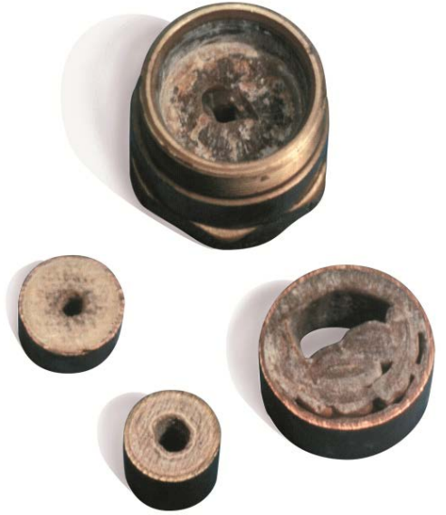
Sert su kullanımı nedeniyle tıkanmış boru
